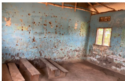
Renovationsbedarf der alten Schulgebäude und Schulräume
