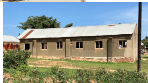
Eine abbruchreife Lehrerunterkunft
