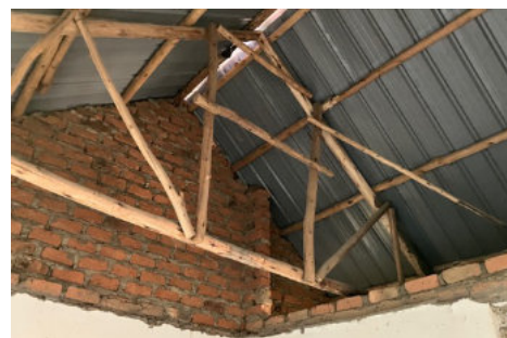
Ein Dachstuhl, der von Termiten zerfressen ist
